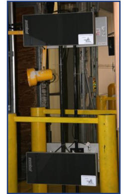
Dock Door RFID Portals
