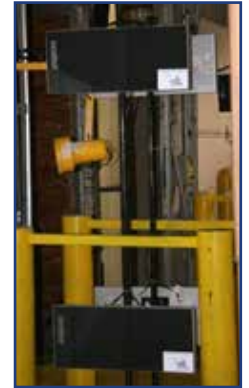
Dock Door RFID Portals
